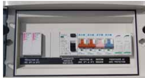
Protections sur OFF
