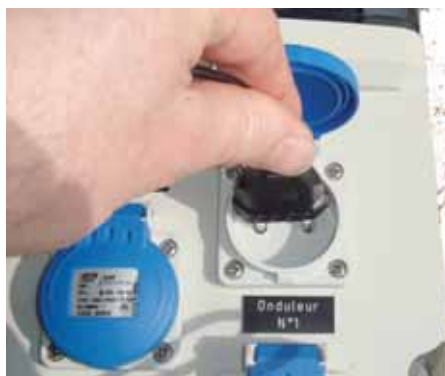
Raccordement des onduleurs et de l'alimentation du régulateur
